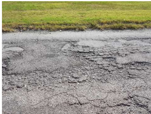
Particolare di solchi sul manto stradale
