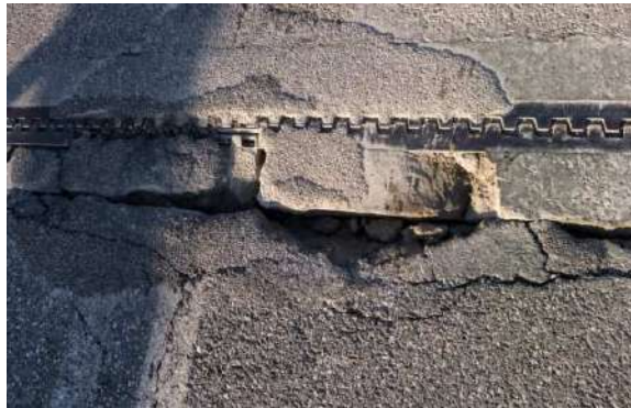
La Strada Ponteboccale si presenta a tratti dissestata
